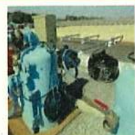
浸透水の集水設備の概観
