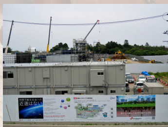
水素利用アンモニア製造施設
