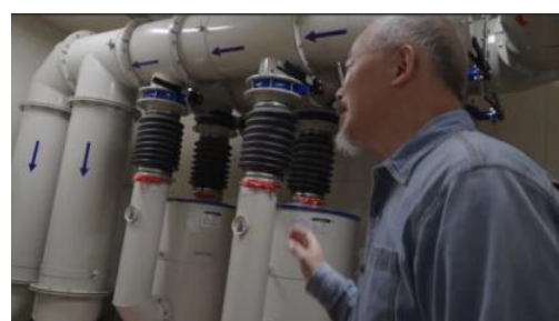
高浜コミュニティセンター（写真上） に設置された陽圧化装置（写真下）
