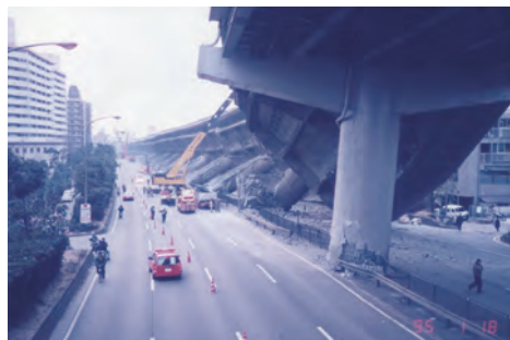
阪神・淡路大震災では高速道路が倒壊 (1995年1月18日/写真提供: 滝谷紘一)
