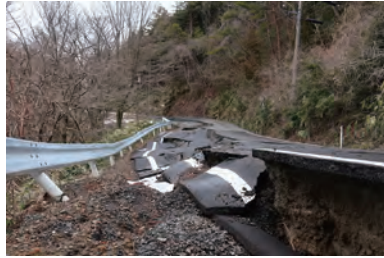
能登半島地震による道路の被害/石川県珠洲市石神町(2024年2月28日/写真提供:北野進)
