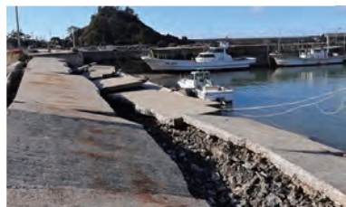
能登半島地震による港の地割れ／石川県珠洲市高屋漁港（2024年1月29日／写真提供：北野進）
